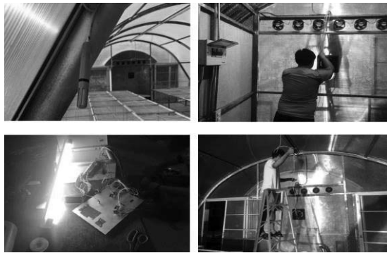
ภาพที่ 12 ดำเนินการติดตั้งเซ็นเซอร์ภายในโรงอบแสงอาทิตย์
