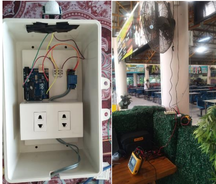
ภาพที่ 6 โครงสร้างพัดลมไอน้ำระบบควบคุมการปิด-เปิดพัดลมไอน้ำอัตโนมัติ
