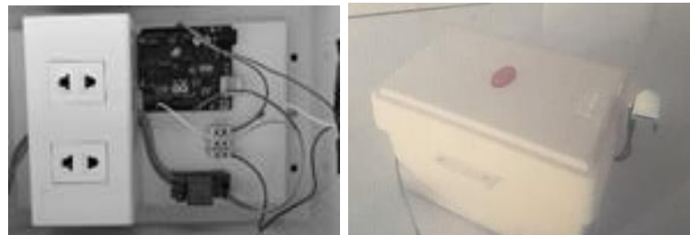
(ข) ต้นแบบระบบควบคุมการปิด-เปิดพัดลมไอน้ำอัตโนมัติ ภาพที่ 2 ต้นแบบระบบควบคุมการปิด-เปิดพัดลมไอน้ำอัตโนมัติ
